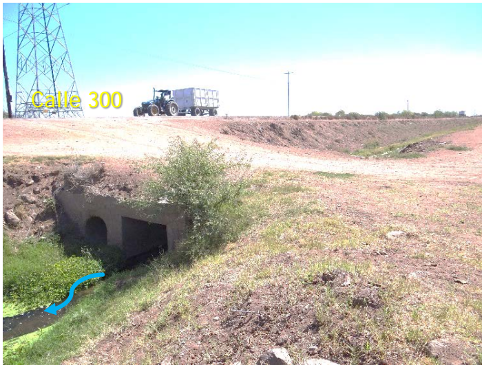
Imagen 5.5.1.6: La estructura de cruce del Dren Calle 300 en el punto de descarga al dren paralelo Canal Principal Bajo. Alcantarilla de cajón de 1.50 x 1.20 metros y tubo de 85 cm.
