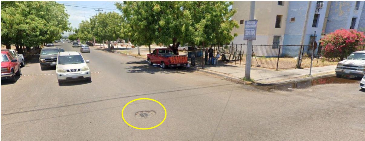
Imagen 5.3.3.5: Rejilla de captación tipo ubicadas sobre la calle Otanchahui. En la inspección se escuchaba agua, por lo que se asume que es parte del sistema de drenaje sanitario.
