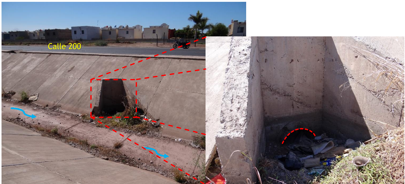
Imagen 3.2.22 y 3.2.23: Descargas del lado sur, también por debajo del nivel de plantilla del dren. El tubo se encuentra obstruido por azolve y basura sin capacidad para desaguar.
