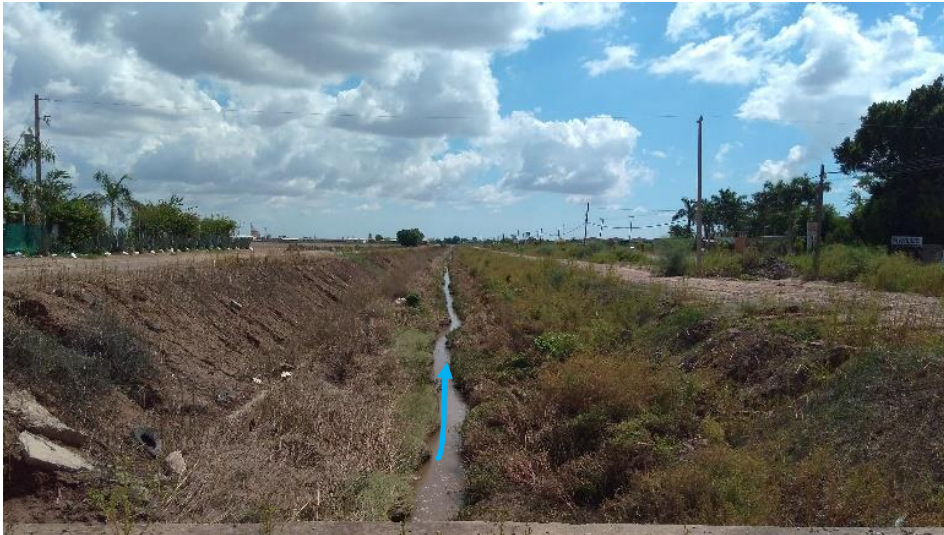
Imagen 3.2.37: Dren Calle 500 después de lluvias, vista rumbo al poniente.
