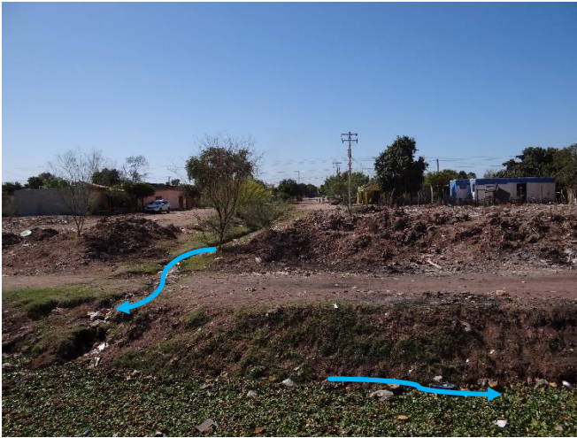
Imagen 3.2.5: Descargas pluviales improvisadas hacia el dren.
