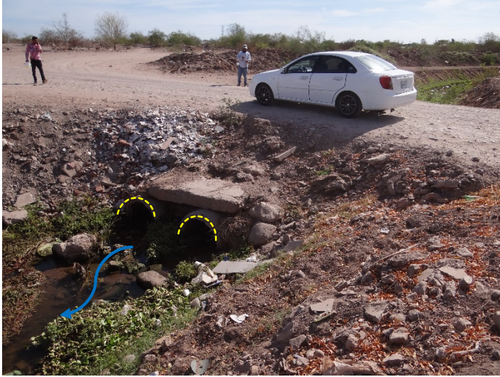
Imagen 5.1.3.2: Para dar acceso vehicular se colocaron dos tubos de 76 cm de diámetro (30") sobre el dren Bordo Prieto en el cruce de la Calle Guadalupe Vázquez.
