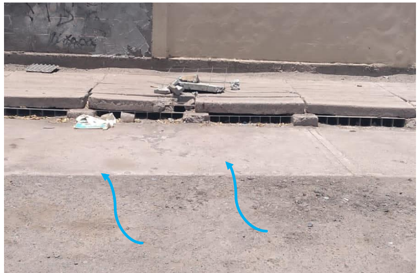
Imagen 5.4.3.7: Captación pluvial en la calle San Pedro Norte, dentro de la misma cerrada. Nuevamente la captación es insuficiente.
