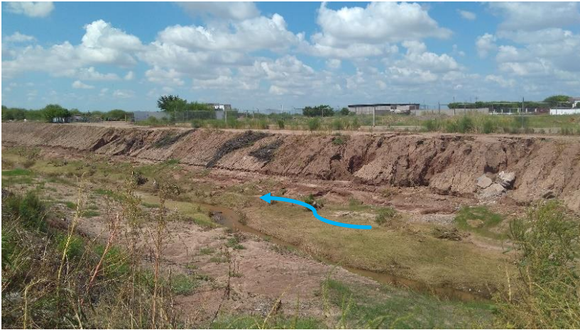
Imagen 3.2.44: Sección del Dren Calle 600 después de una fuerte lluvia.
