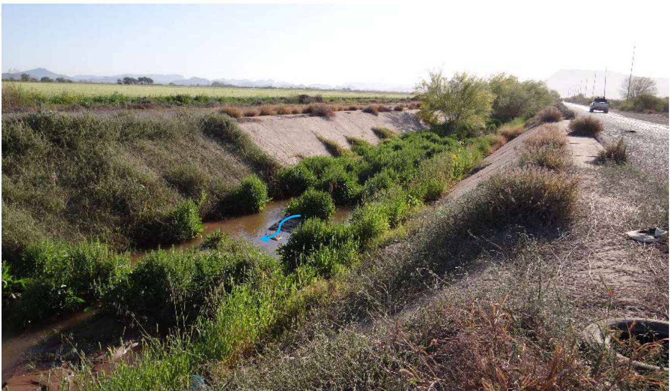
Imagen 5.1.3.11: Condiciones que presenta el Dren Bordo Nuevo en el tramo ubicado al oriente de la Carretera Federal México 15.
