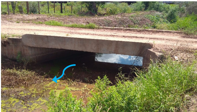
Imagen 5.5.1.2: Estructura de cruce que deja libre todo el claro de la sección hidráulica ubicado en el Dren Calle 500.
