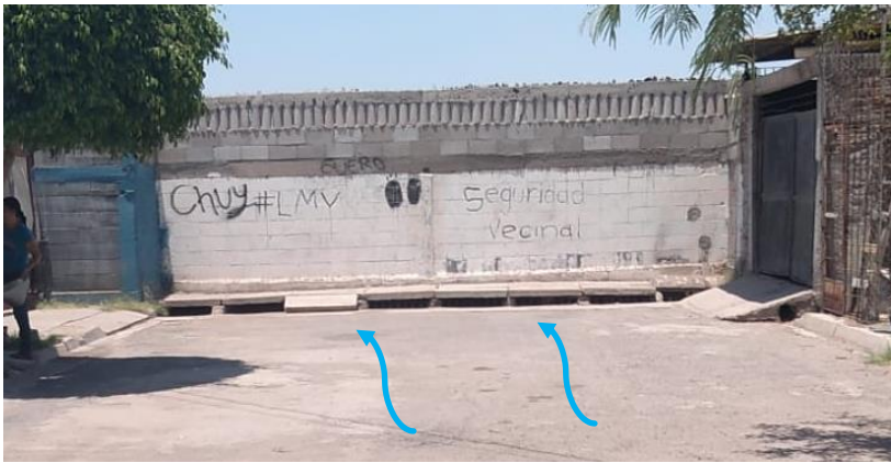
Imagen 5.4.3.6: Se observa una típica captación pluvial en la calle San Isidro Sur, dentro de la cerrada Santa Isabel de la Colonia El Campanario. La captación es insuficiente.
