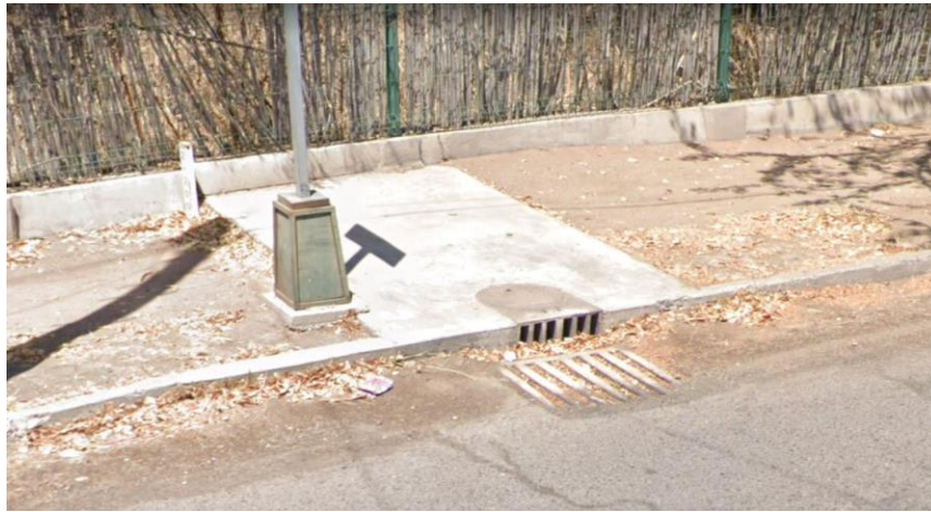
Imagen 3.3.3.7: Boca de Tormenta tipo 1, se encuentran en algunas zonas de la ciudad. Imagen tomada sobre la Calzada Ostimuri alrededor del Parque Infantil.
