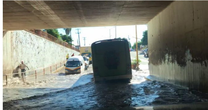
Imagen 5.4.3.21: Inundaciones frecuentes en el paso a desnivel de la calzada Francisco Villanueva.
