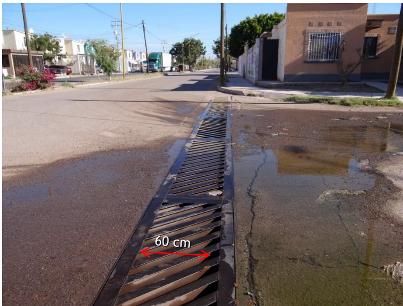
Imagen 3.3.3.1: Rejilla transversal colocada a lo ancho de la calle (boca de tormenta).
