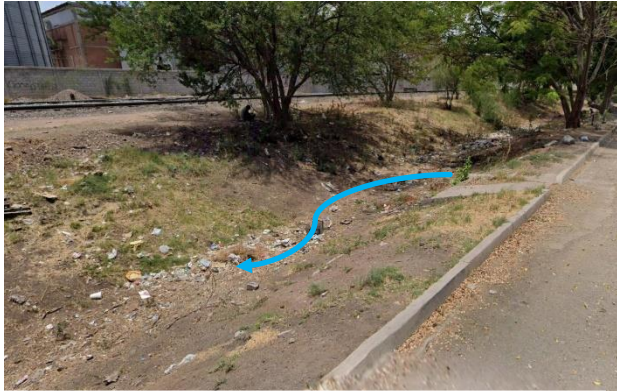
Imagen 5.4.3.14: Canal pluvial entre la vía del ferrocarril y la calle Fray Servando Teresa De Mier. Se observa que se requieren más lavaderos para descargar el agua al canal.
