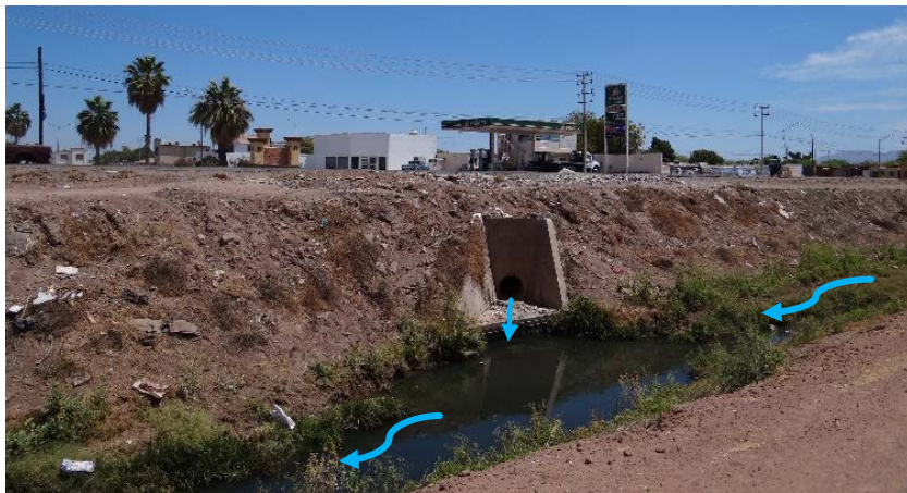
Imagen 5.5.2.7: Descargas tipo ubicadas sobre el Dren Calle 300.
