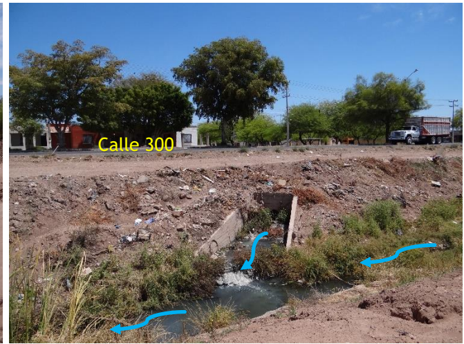
Imagen 3.2.27: Descarga de subcolectores pluviales, sobre los cuales existen descargas sanitarias.
