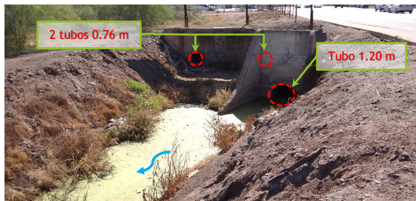
Imagen 3.2.20: Inicio del dren a cielo abierto de la Calle 200, donde se observan los tubos de descarga.
