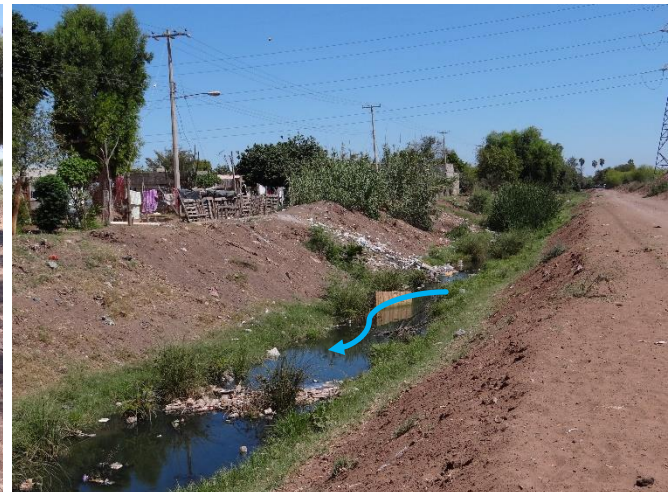
Imagen 3.2.41: Condiciones del dren en el tramo entre Calle 200 y Calle 300.
